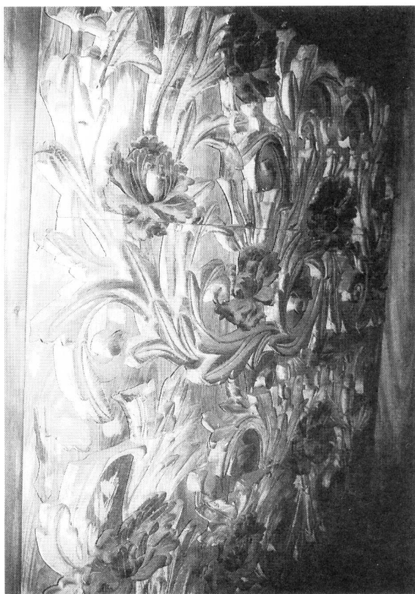
图16 都久夫須麻神社本殿 庇側面板壁
